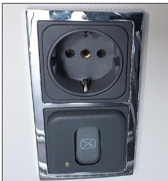
230 V-Steckdose die vom Wechselrichter versorgt wird (Abb. beispielhaft)
