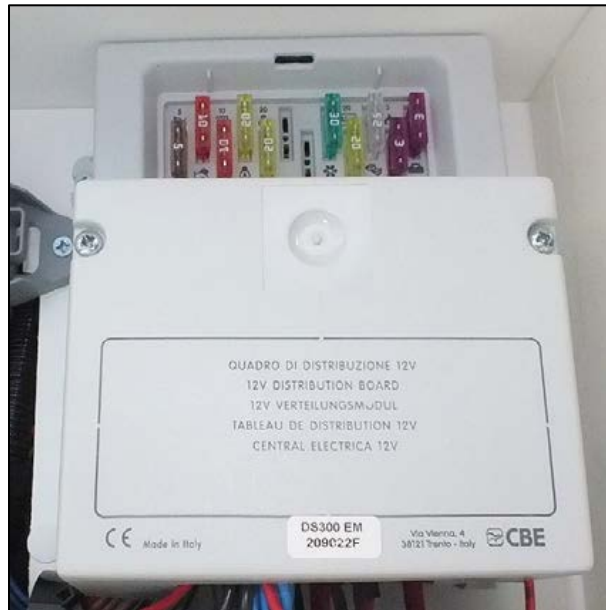
12 V-Sicherungskasten mit Verteilerfunktion (Abb. beispielhaft)
