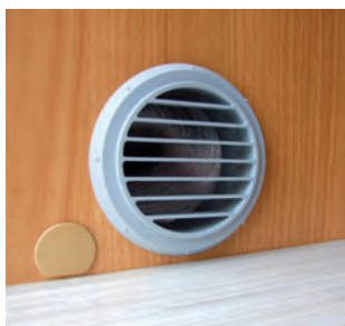
Ansaugöffnung für kalte Luft
