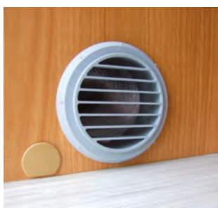
Ansaugöffnung für kalte Luft
