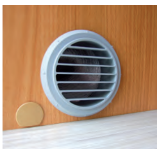
Sugeåpning for kald luft
