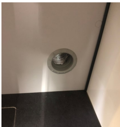
Lüftungsöffnung für warme Luft
