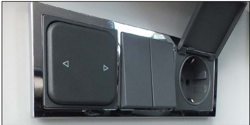
Schalter und Steckdose am Küchenblock (Abb. beispielhaft)
