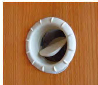
Lüftungsöffnung für warme Luft
