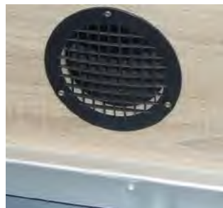
Ansaugöffnung für kalte Luft
