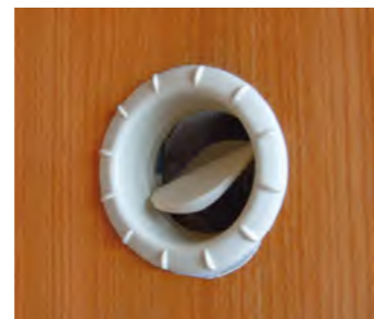
Lüftungsöffnung für warme Luft
