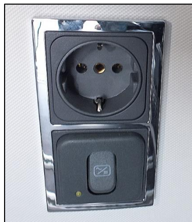
230 V-Steckdose die vom Wechselrichter versorgt wird (Abb. beispielhaft)
