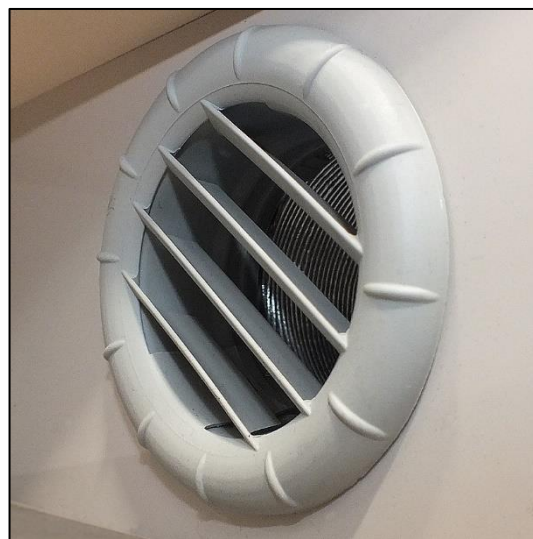
Ansaugöffnung Umluft (Abb. beispielhaft)
