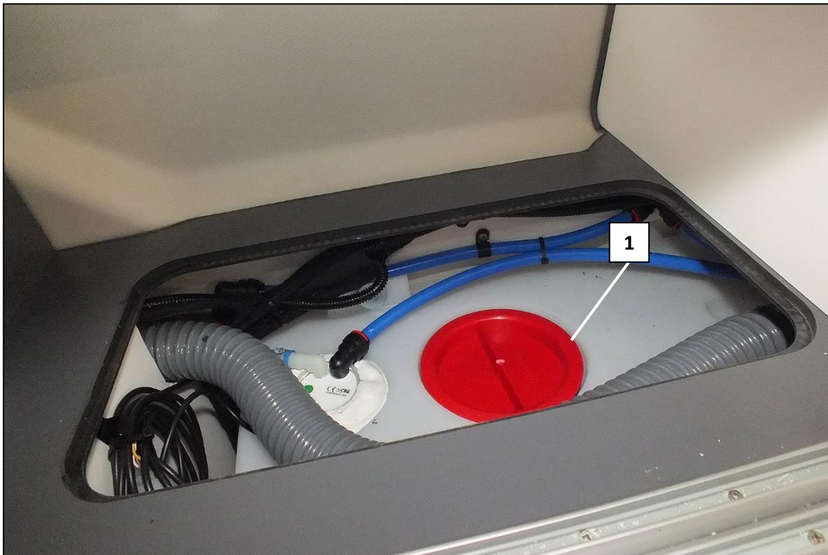
Frischwassertank unterhalb des Wandschranks beim Duncan 495 (Abb. beispielhaft)
