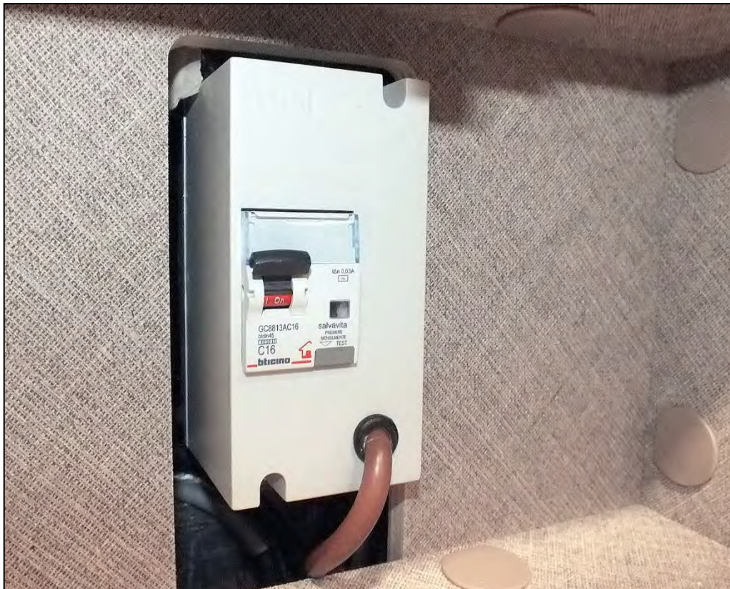
Coupe-circuit 230 V avec disjoncteur différentiel (exemple)
