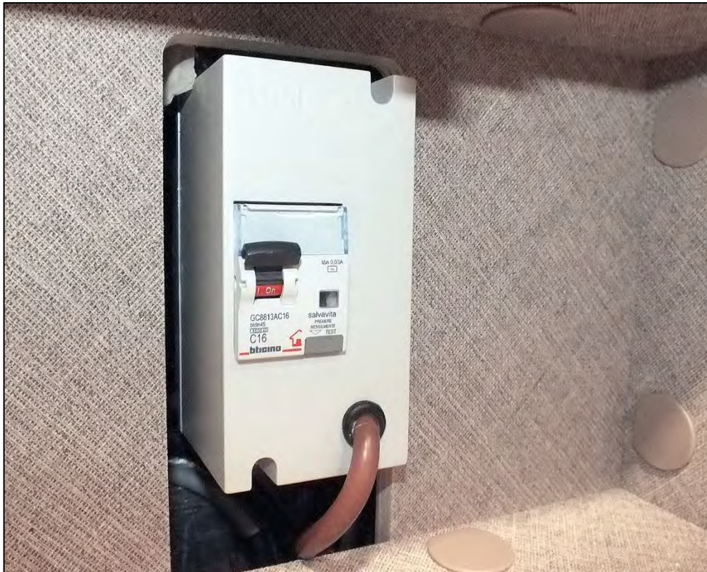
230 V-Absicherung mit FI-Schutzschalter (Abb. beispielhaft)
