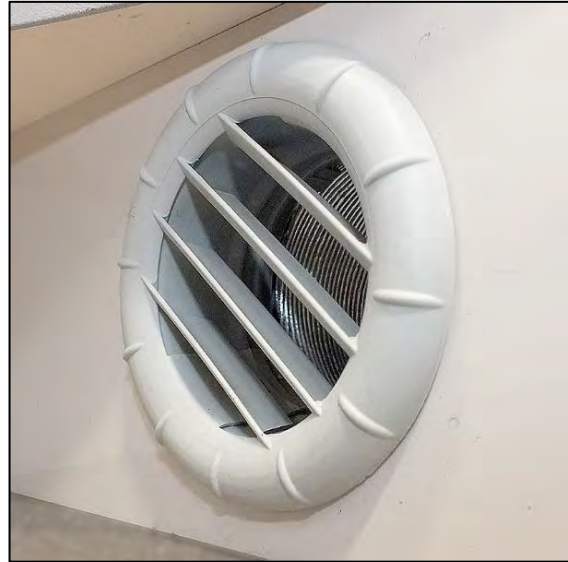
Ansaugöffnung Umluft (Abb. beispielhaft)
