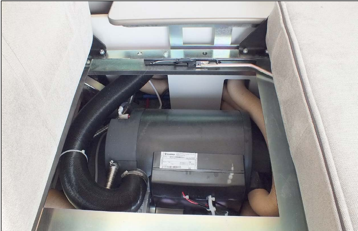
Heizungsanlage unter der Sitzbank
