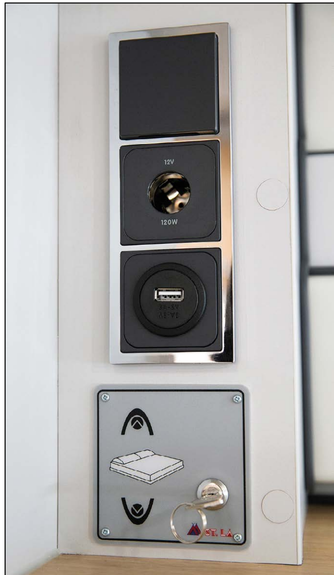
Steckdosen oberhalb des Kleiderschranks
