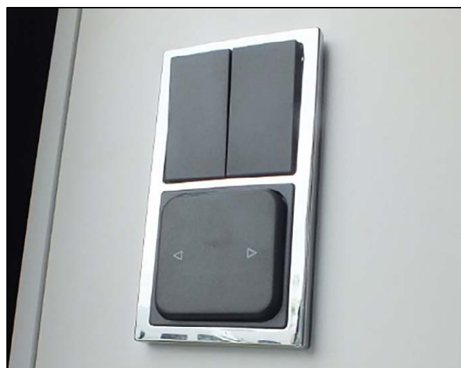
Schalter am Küchenschrank im Eingang
