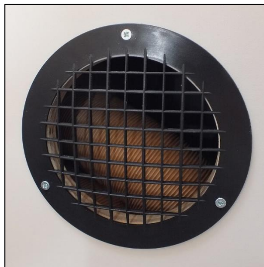
Orificio de aspiración de aire circulante
